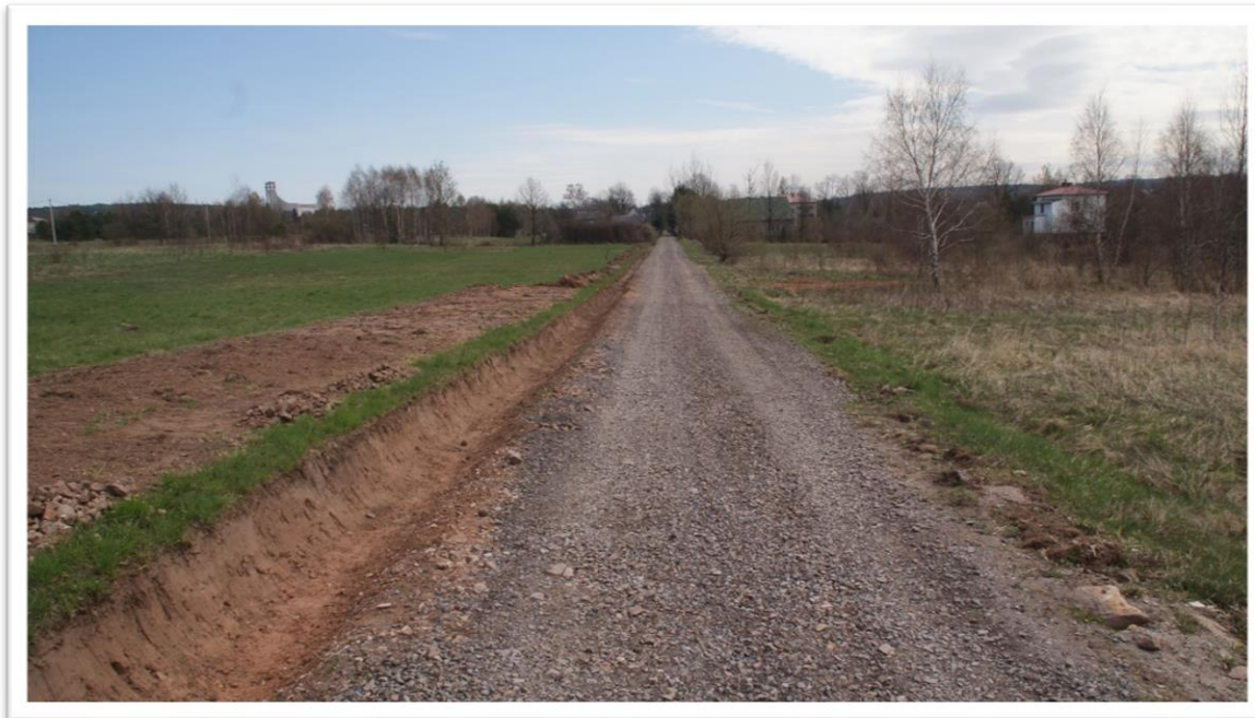
❖ Remont drogi w msc Samsonów – Piechotne „Kępa”, udrożnienie rowów i wykonanie nakładki z kruszywa
